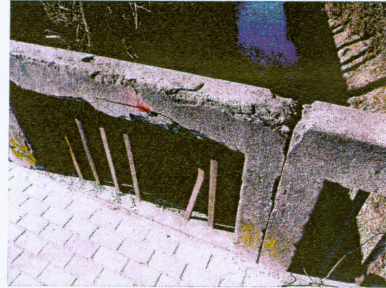
Poręcz po stronie prawej. Ubytki i spękania betonu, ubytki i luźne elementy wypełnienia poręczy, korozja stali.
